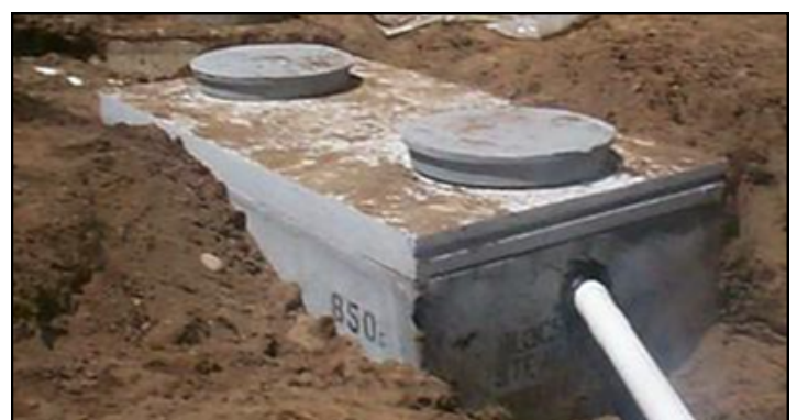
Fosse septique (béton)
